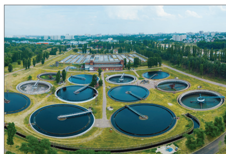
供水和废水管理
